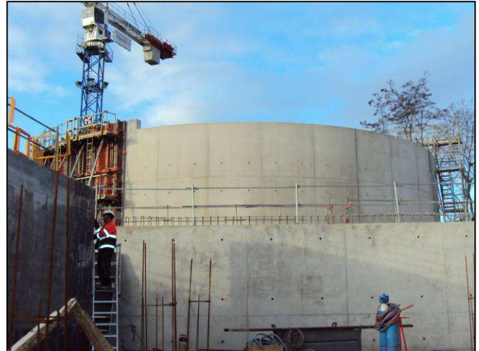
01/04/2010 : Bassin biologique 1 et voiles des la bache n°15
